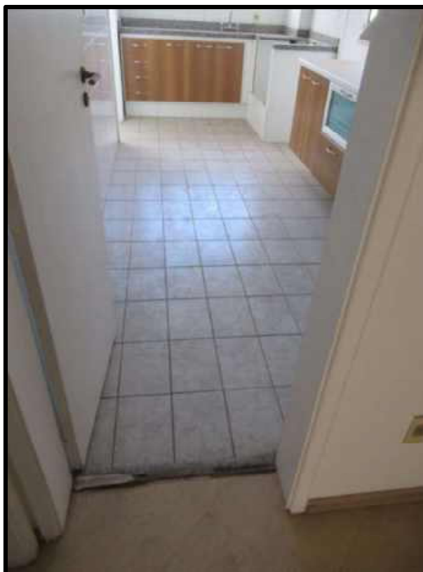
Foto 42: Piso deteriorado da entrada da cozinha
