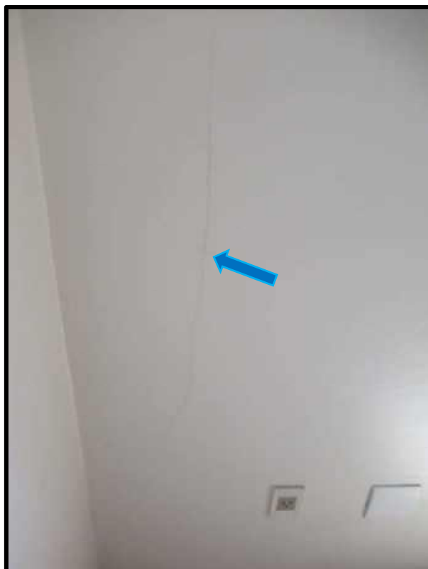
Foto 46: Detalhe da trinca na parede da janela
