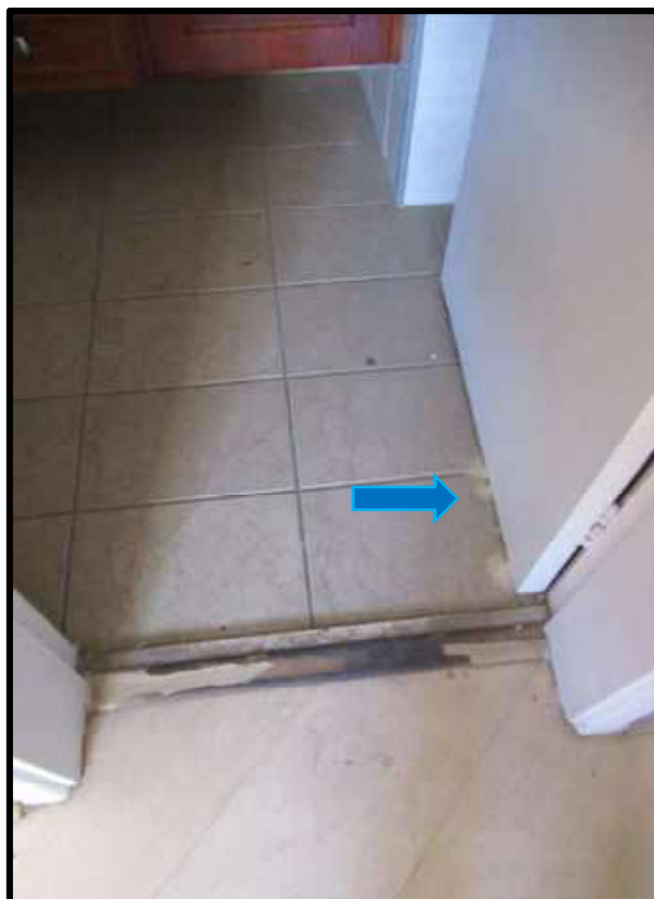
Foto 48: Piso da entrada do banheiro deteriorado e cupim
