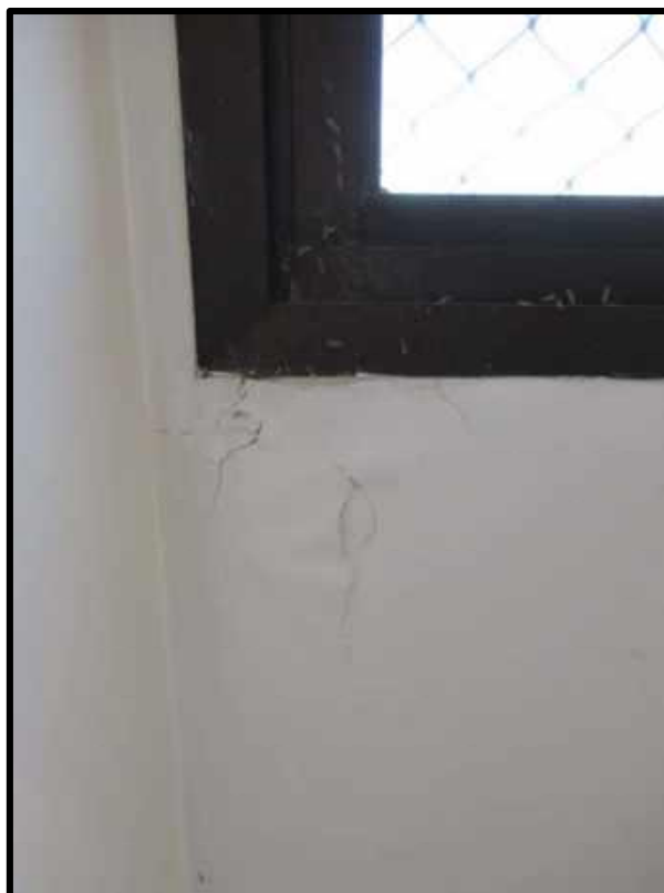
Foto 21: Janela com vestígio de infiltração de água
